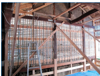
外壁の竹小舞と、柱の根継ぎ
